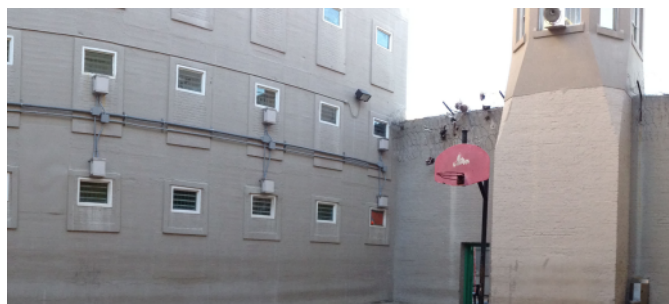
Zdjęcie: instalacja na zewnątrz na terenie Orleans Parish Prison, Nowy Orlean (Stany Zjednoczone)
